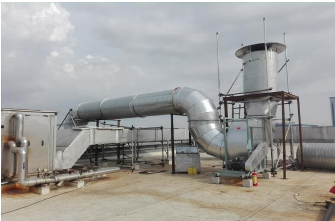
Hệ cấp khí tươi nhà máy cocacola Thủ Đức
