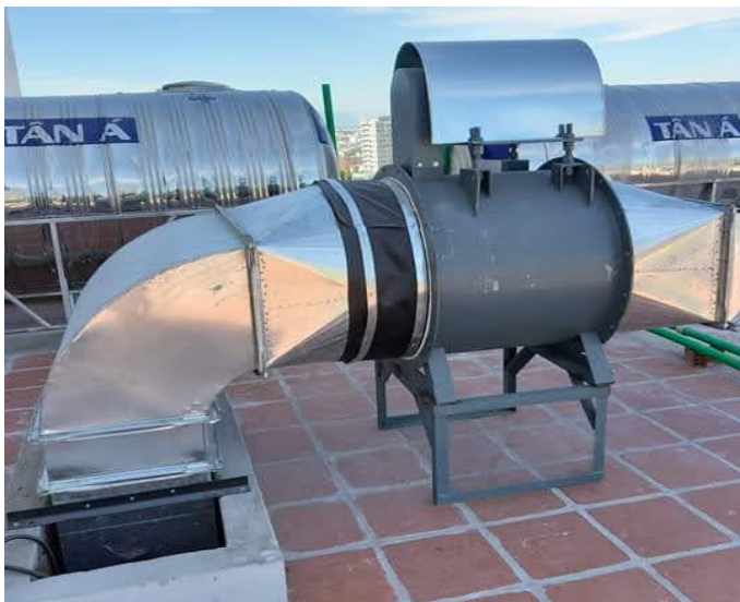
Hệ thống tạo áp cầu thang khách sạn conotel
